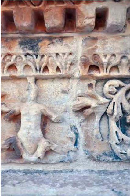
Ephesos, Hadrianstempel. Antrag von Ergänzungsmasse entlang eines Risses zur Verhinderung des Eintrags von Niederschlagswasser (Foto M. Pliessnig)
