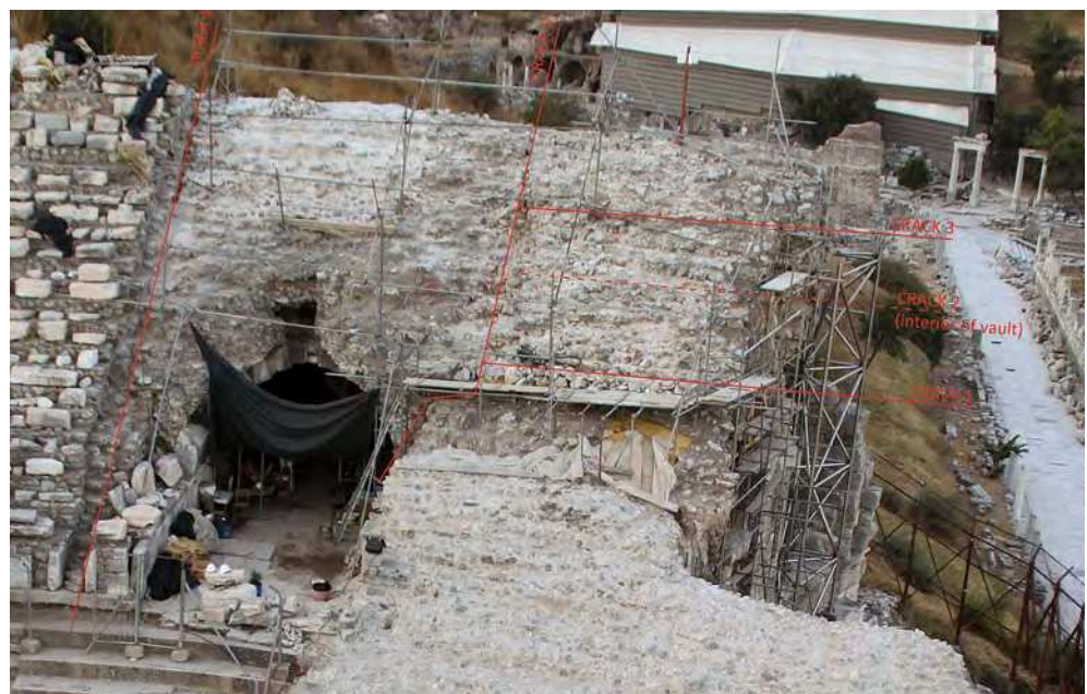
Ephesos, Großes Theater. Risse am Südanalemma
