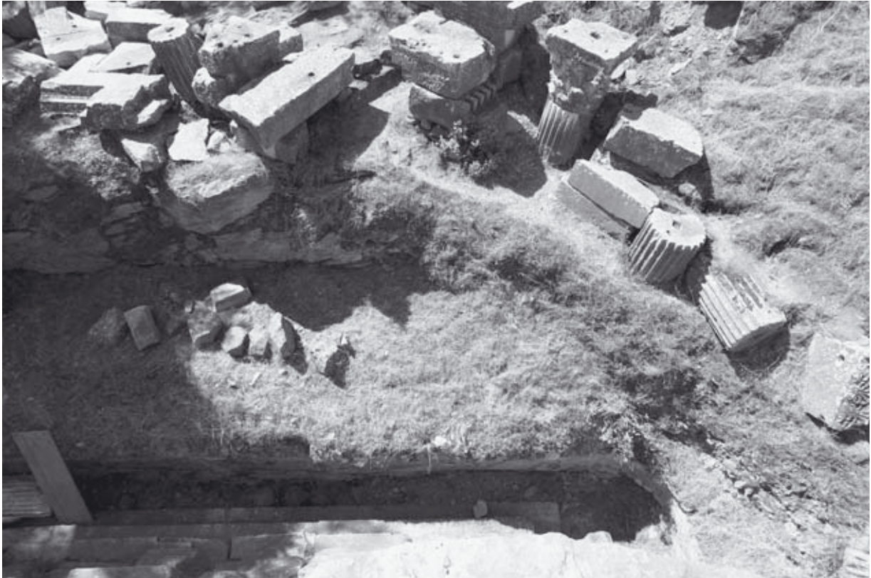
Taf. 46, 1: Beschädigte ausbauchende Südwand der Arisiton-Leitung (2003)
